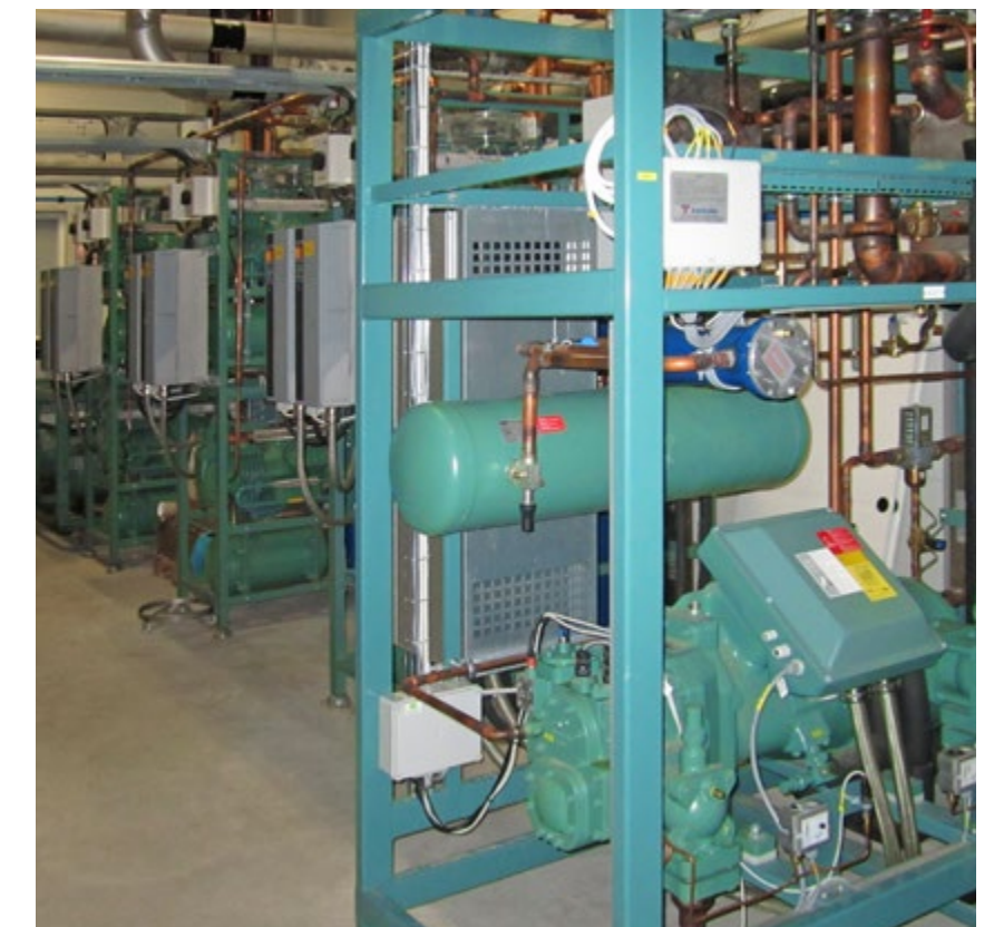
BITZER Verdichter im Einsatz bei Frostab
